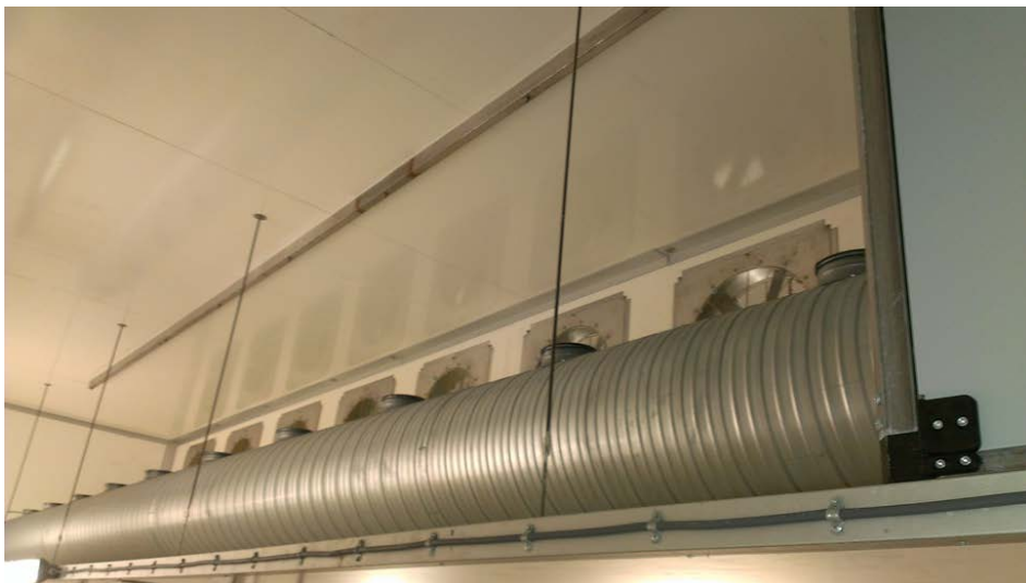
Figur 6: Sirkulasjonsvifter i kammertørken, samt kanal fra kjøleaggregat.
